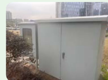
深圳欧菲光项目雨水回收系统
